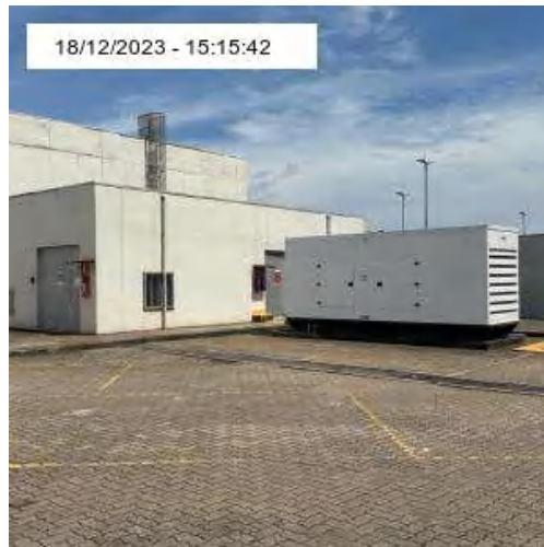
Casa de maquinas
