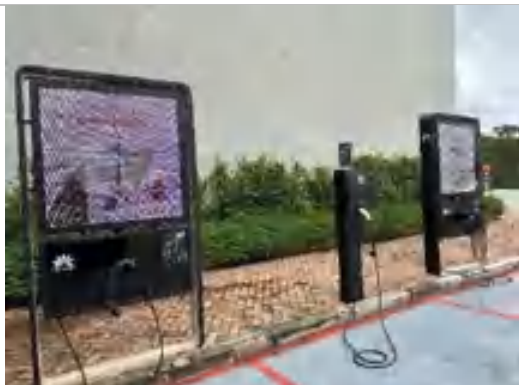
Carregadores para veículos elétricos
