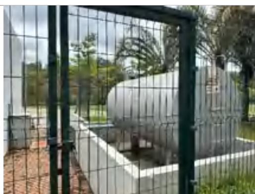
Tanque diesel do gerador
