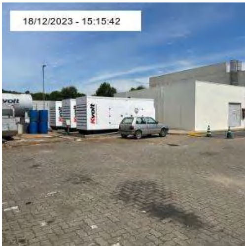
Casa de maquinas
