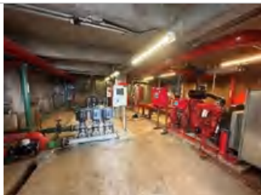
Central de bombas
